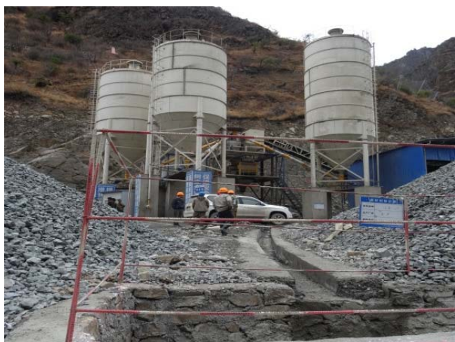
图(3) 固滴川工局拌和系统冲洗废水沉淀池
