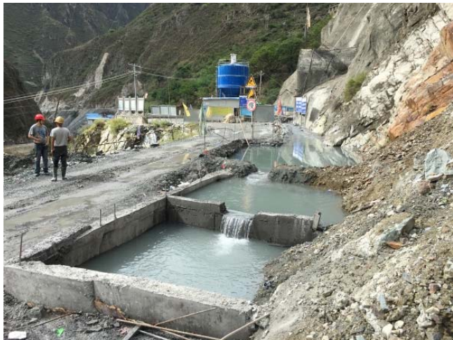
图(1) 固滴中水十六局3#支洞洞室废水沉淀池
