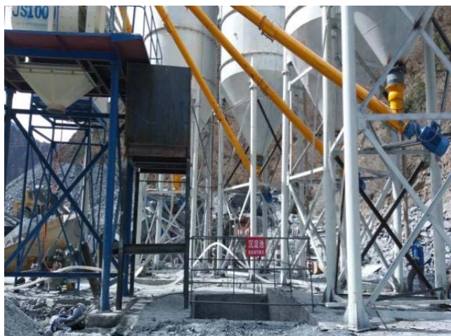
图(4) 固滴中铁十八局拌和系统冲洗废水沉淀池
