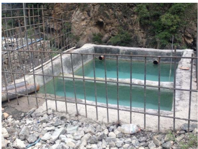
图(2) 固滴中水十六局4#支洞洞室废水沉淀池
